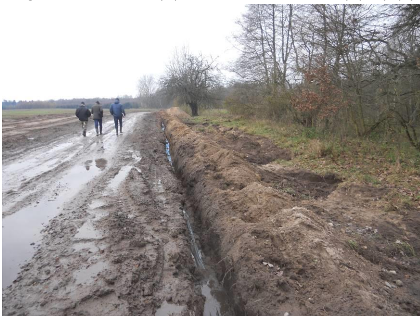
Z terenu gospodarstwa wzdłuż dogi prowadzony jest podziemny kabel elektryczny do budowanych obiektów na części działki nr 233, na której przebywa kilka tysięcy krów.
