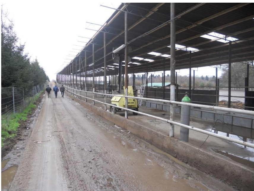
Wiaty kryte eternitem wznoszone bez pozwolenia na budowę.
